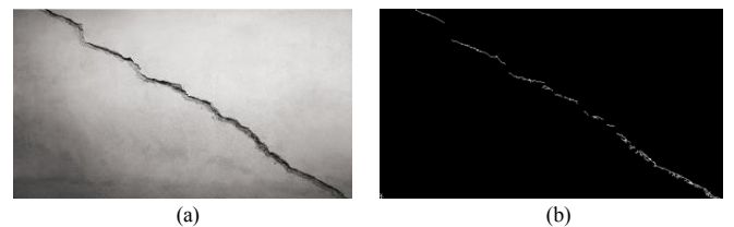
Fig. 11. Imagen procesada de grieta diagonal en muro divisorio a) Imagen original a color y b) Forma y delimitación de la grieta detectada al finalizar su procesamiento.
