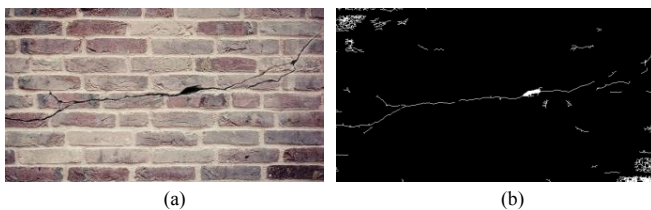
Fig. 8. Imagen procesada de grieta superficial en muro divisorio hueco a) Imagen original a color y b) Forma de la grieta al finalizar su procesamiento.
