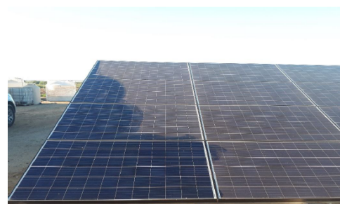
Figura 4. Imagen del panel solar con sección limpia y sección sucia por polvo.
